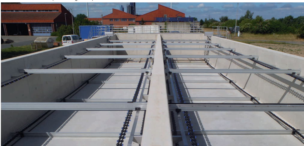
Ketten- und Bandräumer (Trichter abgedeckt)
